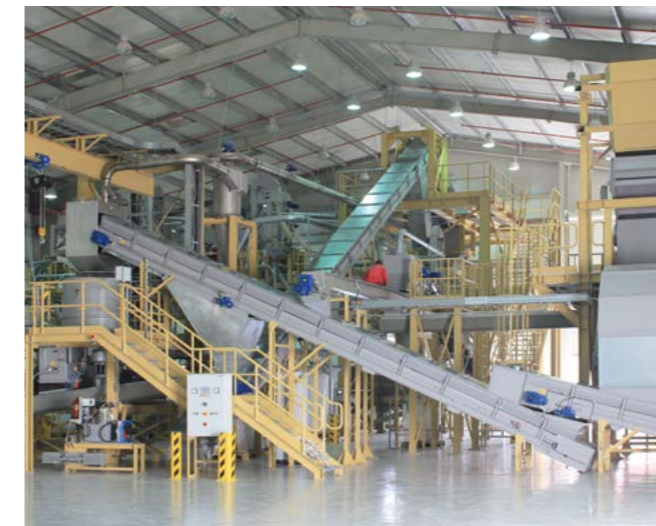
↑ Installation de recyclage d'un débit de 20 000 t/a
