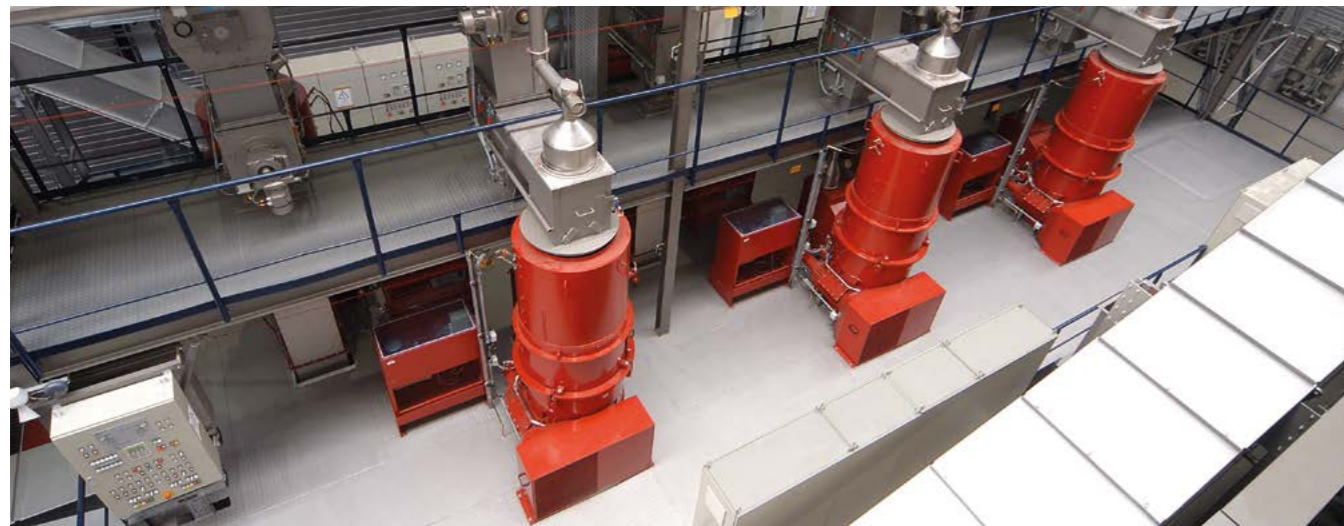
↑ Installation de recyclage d'un débit de 100 000 t/a
