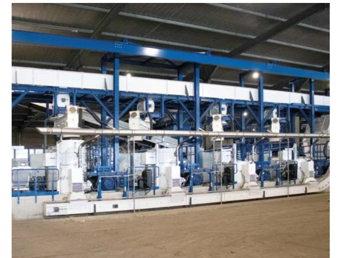
↑ Installation de recyclage d'un débit de 85 000 t/a
